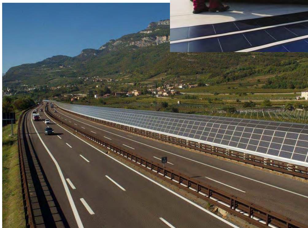
Panouri fotovoltaice - barieră fonică
