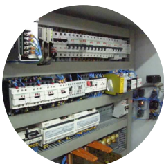
DISTRIBUTIE ELECTRICA SI COMANDA
